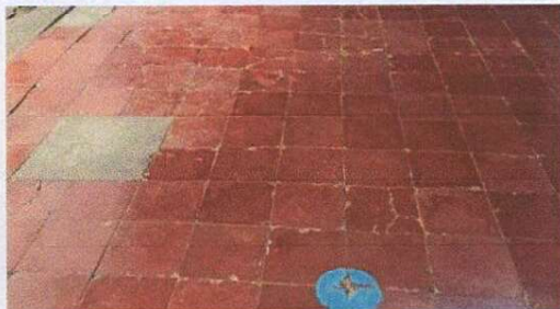
Foto1: Sustrucion de piso en mal estado
